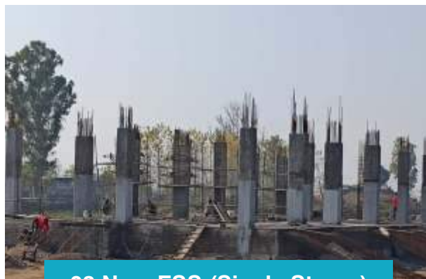
03 Nos. ESS (Single Storey)
